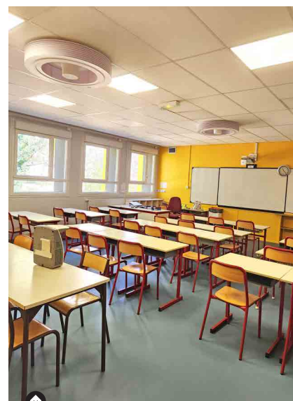
Toutes les classes ont été rénovées, et dotées de brasseurs d'air de nouvelle génération. Ici en élémentaire.
